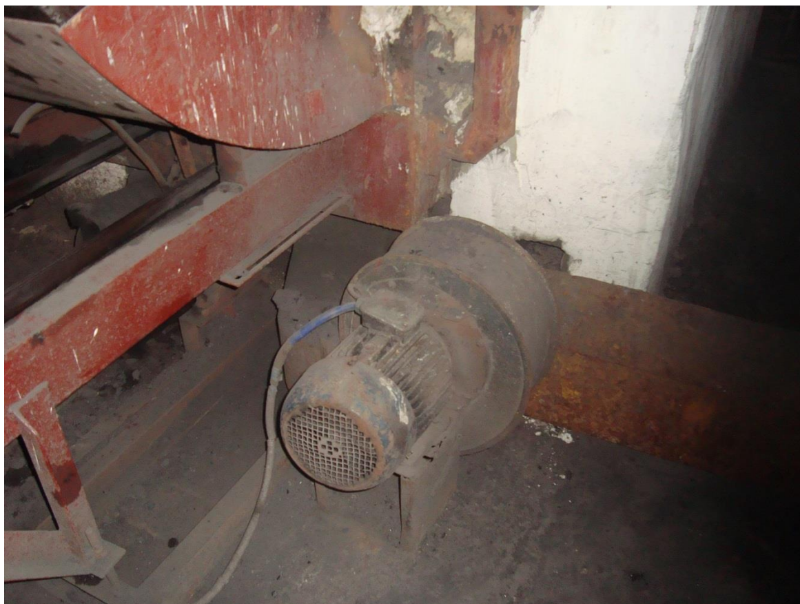
Рисунок 1.5 – Дутьевой вентилятор котельной с. Новоярково
