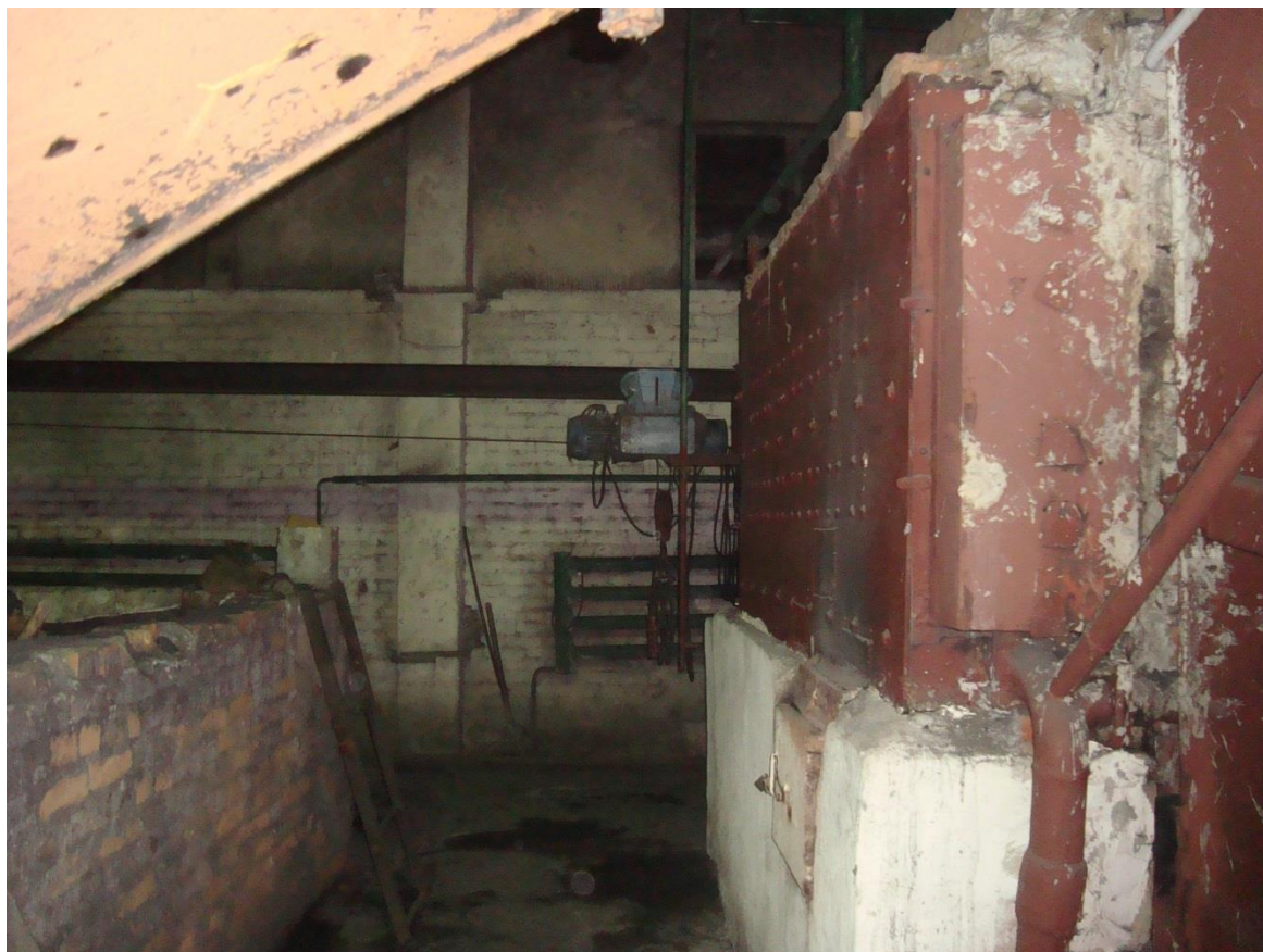
Рисунок 1.3 – Котельное оборудование, установленное на котельной с. Новоярково
