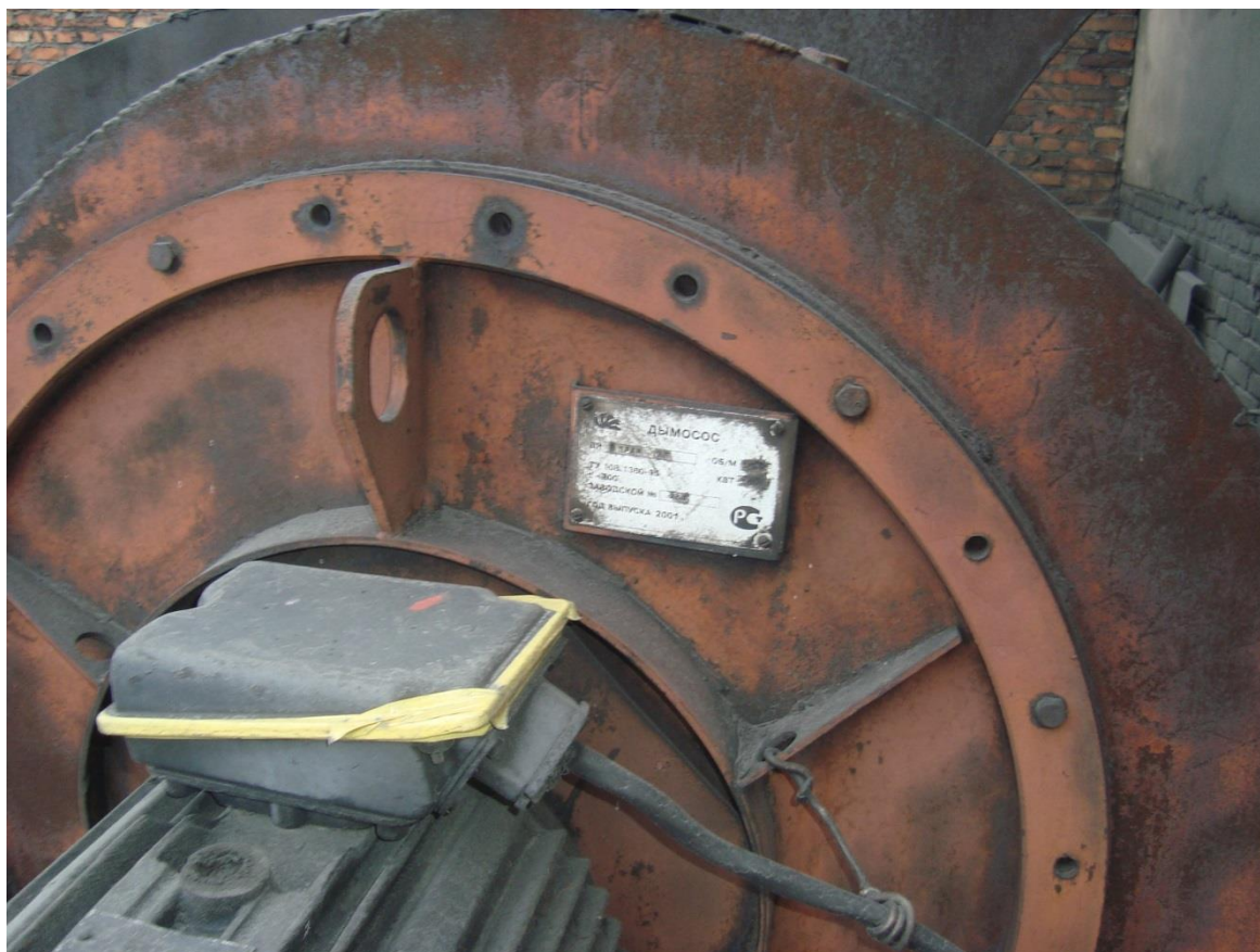
Рисунок 1.6 – Дымосос котельной с. Новоярково
